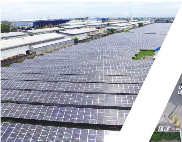
3.35 MW Solar Power Plant : สหกรณ์การเกษตร บางบัวทอง จำกัด
