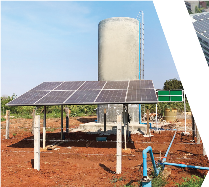
843 kW ระบบสูบน้ำพลังงานแสงอาทิตย์ : กองอำนวยการรักษาความมั่นคงภายในภาค 2
