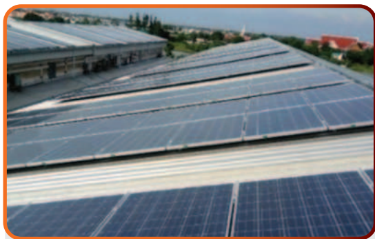
Solar Rooftop : โรงงาน AKR
